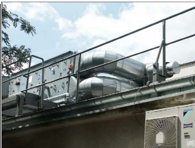
Nowe urządzenia klimatyzacyjne
